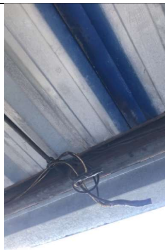
Emenda da Alimentação dos Equipamentos das Salas 9 e 11
