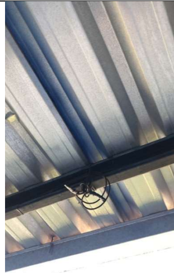
Emenda da Alimentação dos Equipamentos das Salas 3 e 5
