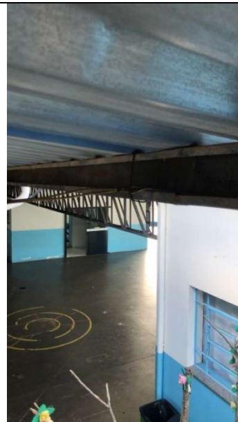
Emenda da Alimentação dos Equipamentos das Salas 2, 4 e 6
