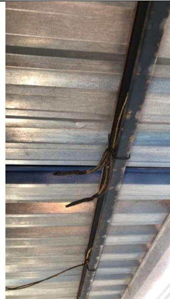
Emenda da Alimentação dos Equipamentos das Salas 4 e 6
